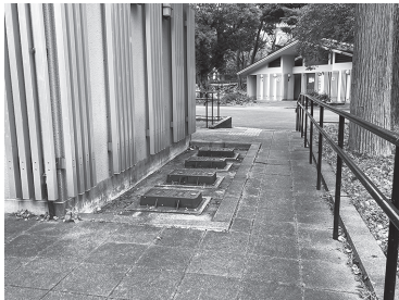
マンホールトイレ (4穴) 39)
